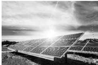
太陽光発電所
